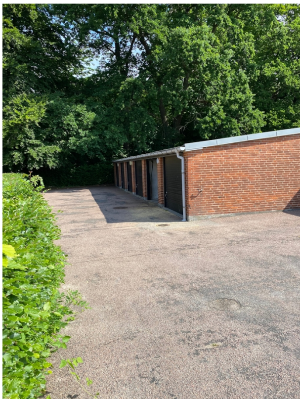
Asfalt areal ved garager mod Blok B fremstår med lidt huller og revner i belægningen
