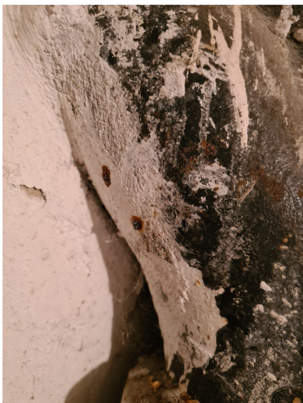
Gammel faldstamme i kælder med tæring
