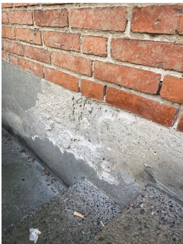
Afskalning på sokkel ved kældertrappe
