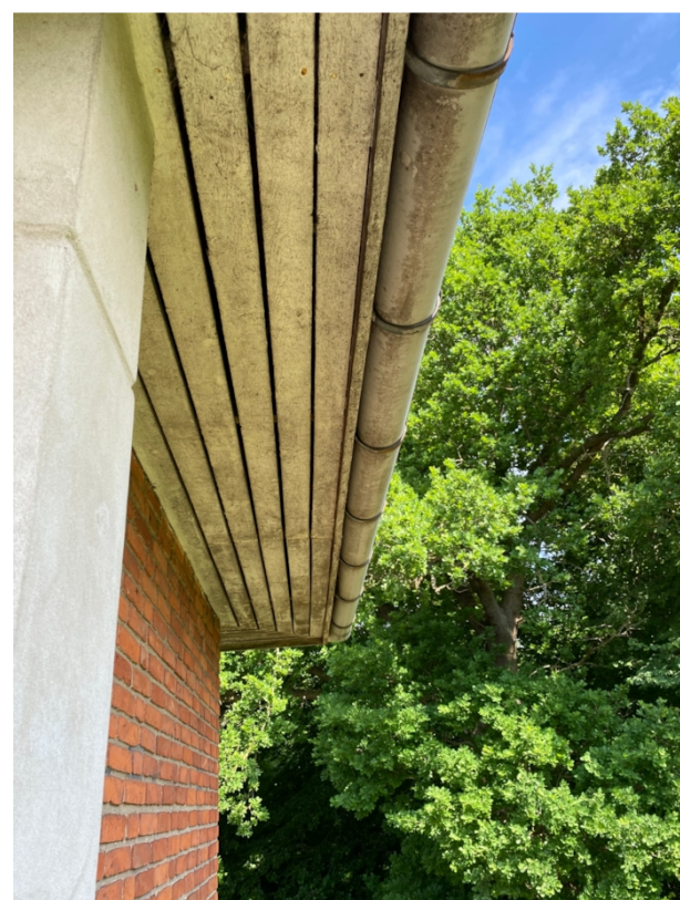
Underbrædder i udhæng fremstår slidte. Brædderne kan formentlig bevares og afvaskes, samt males for at friske dem op.
