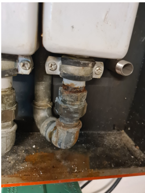
Tæring ved tilkobling af BWT vandbehandling
