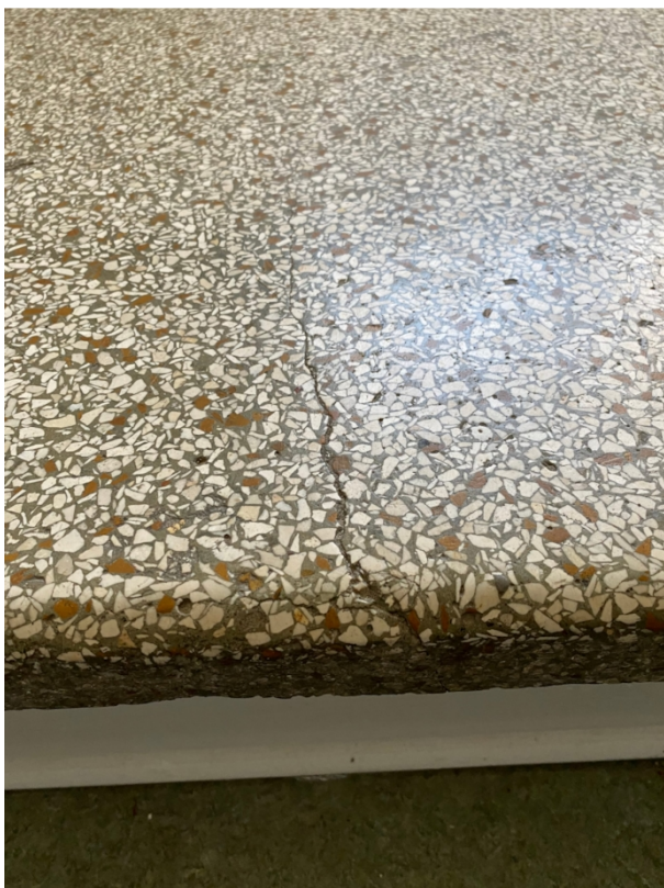
Der ses lidt mindre revner i terrazzo i indgangsreposer
