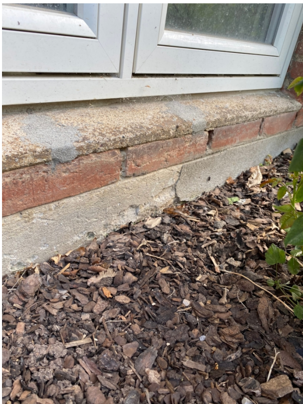
Der ses en del steder afskalninger og mindre revner på sokkel
