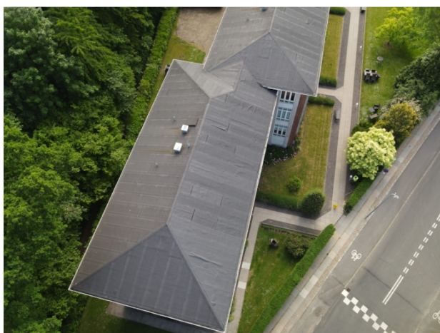
Blok B - Der ses rigtig mange dampbuler i tagpapen. Det er tegn på at der trænger fugt ind under overpappen.
