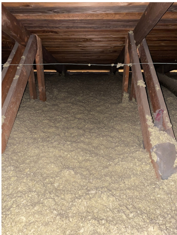
Loftrum. Brædder under tagpap ser generelt ok ud. Det forventes kun at en mindre del skal udskiftes ifm. tagarbejde.
