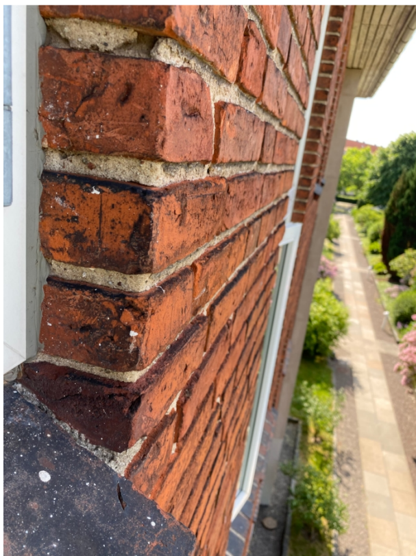
Mange steder fremstår fuger udvaskede og porøse
