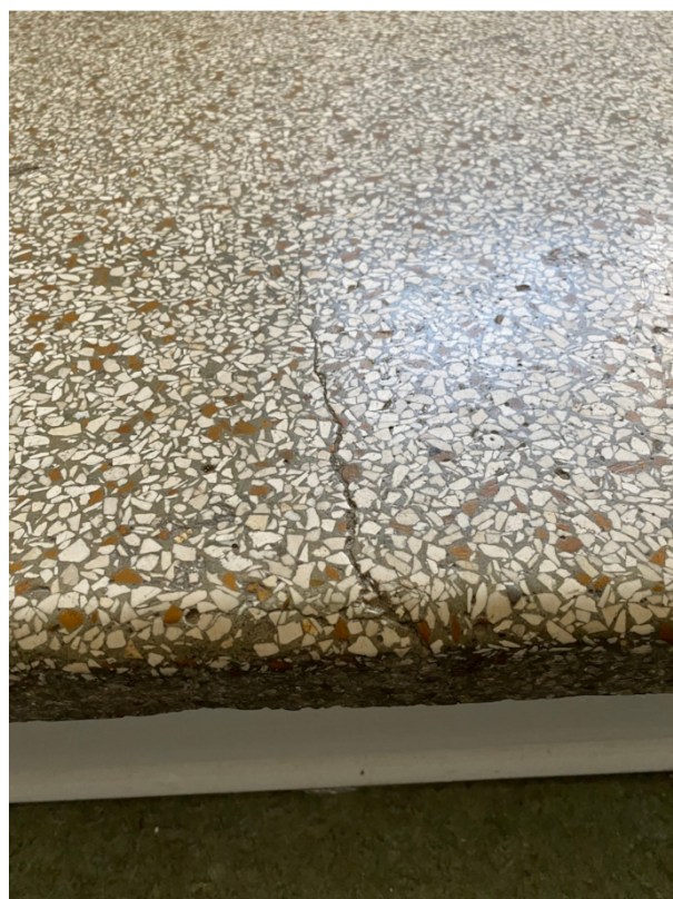
Der er registreret enkelte mindre revner i terrazzo gulve ved indgangsreposer i hovedtrapper
