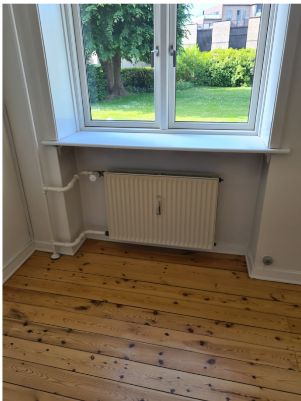
Radiator i lejlighed
