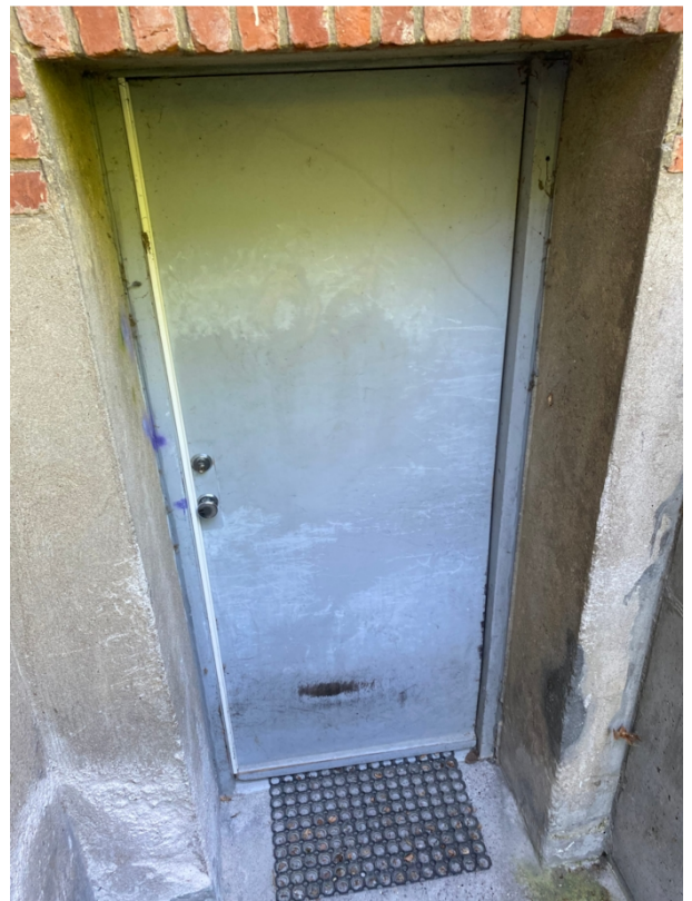
Udvendig kælderdoor fremstår slidt
