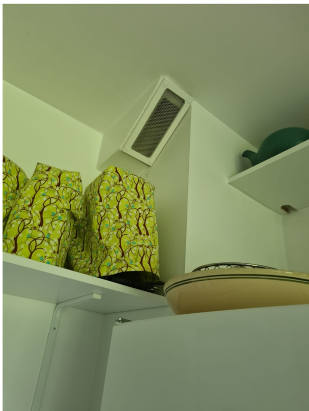
Aftrækskanal med påmonteret rist.
