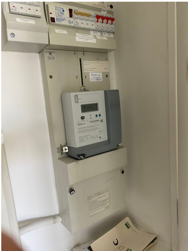
El-tavle til lejlighed placeret i skab i trappeopgang.
