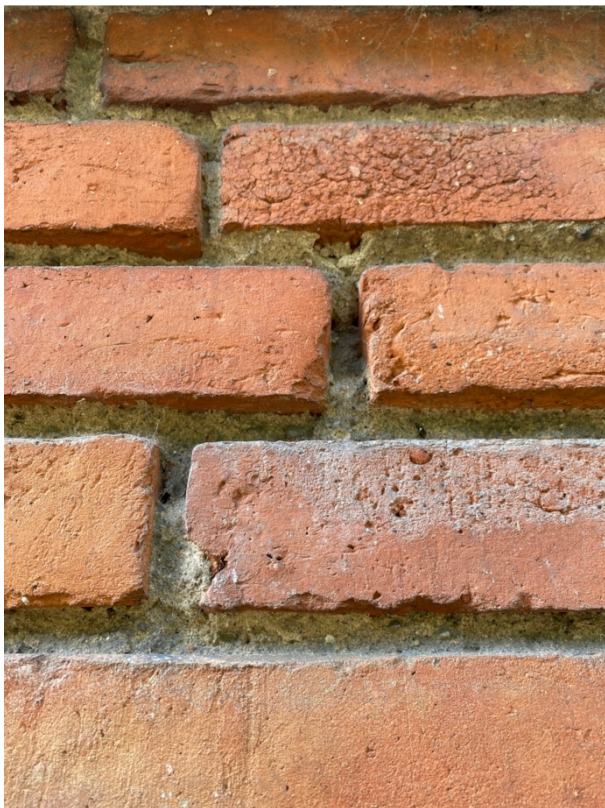
Mange steder fremstår fuger udvaskede og porøse
