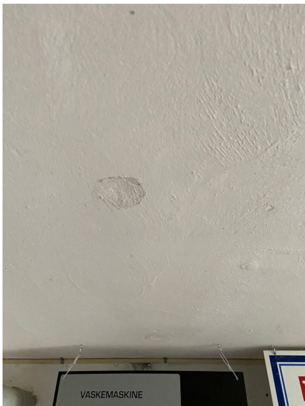
Gammelt indblæsningshul i kælderloft
