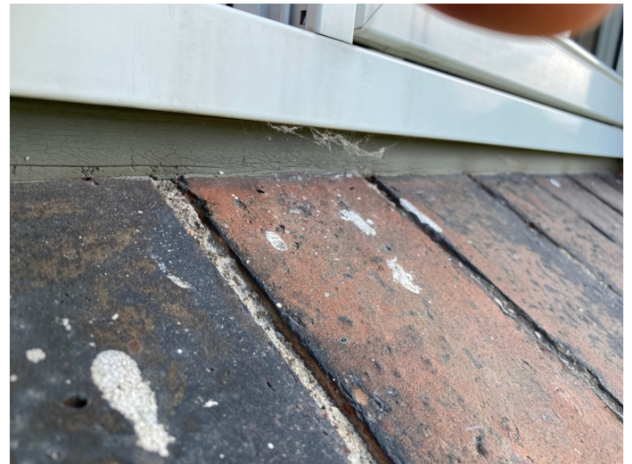
Vinduesfuger fremstår intakte, tætte og fleksible. Der ses dog tegn på slidtage på især bundfuger.
