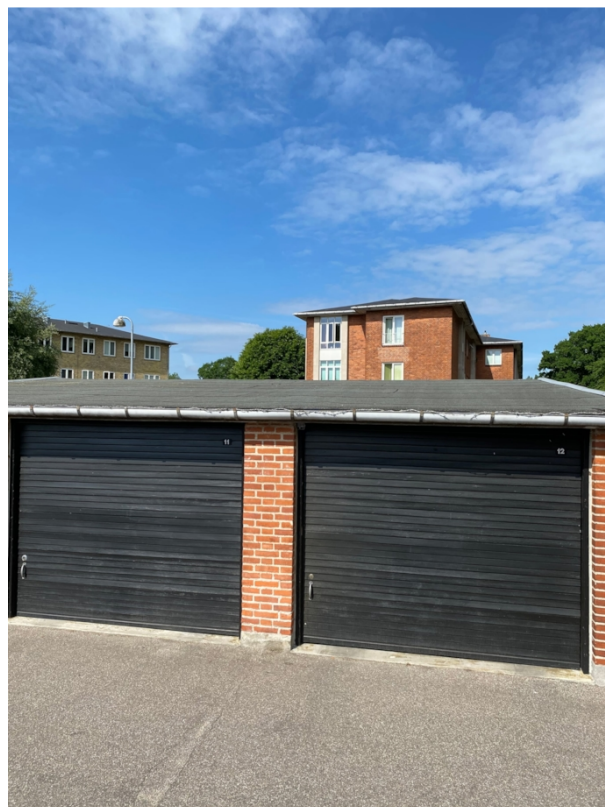
Tagpapbelægning på garage ser noget ujævn ud. Det er dog svært at vurdere standen af tagpappen fra terræn.
