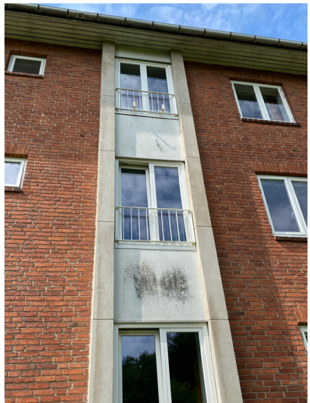
Eternitplader på brystninger fremstår generelt intakte, men nogle steder tilsmudsede med algebelægninger o.l.
