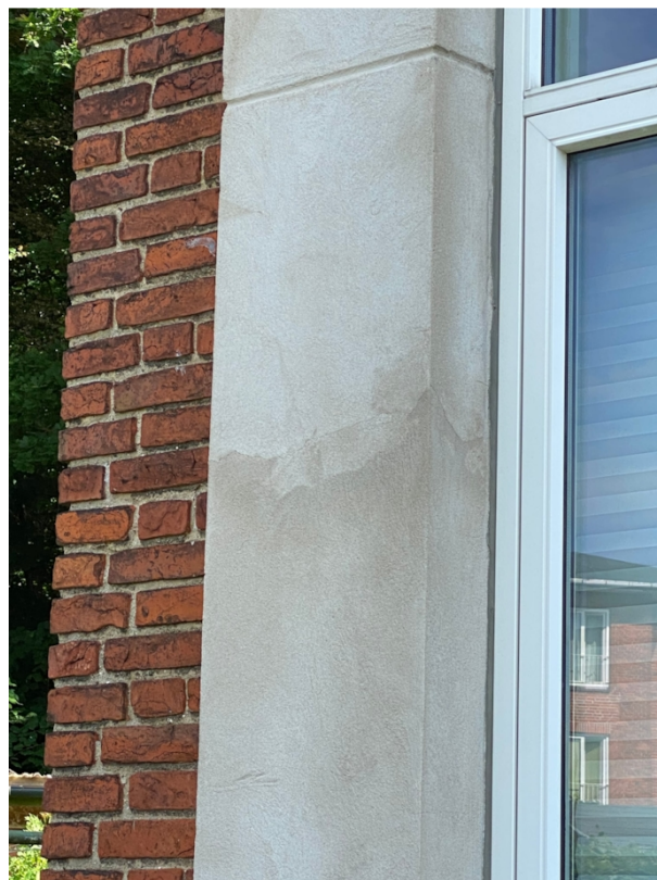
Flere steder ses mindre revnedannelser på de pudsede "søjler".
