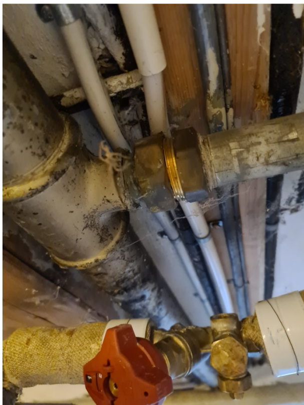
Radiatortilkobling på vandrør (ikke godkendt til brugsvand).
