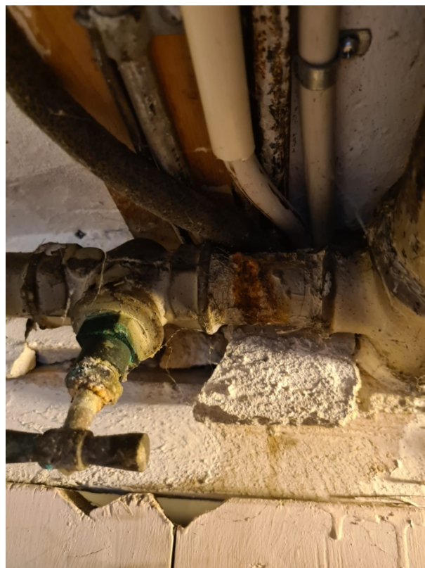
Tæring på vandrør i kælder
