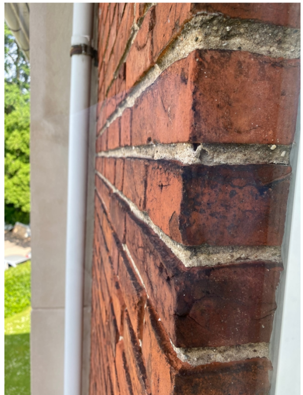
Mange steder fremstår fuger udvaskede og porøse
