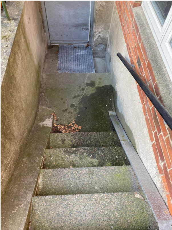
Kældertrappe hvor der ses lidt revner i gulvet
